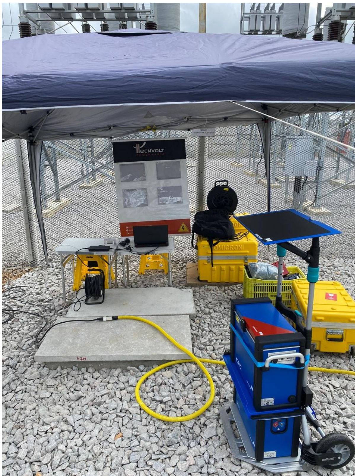
Ensaio de fator de potência e capacitância da isolação com o CPC 100 da OMICRON e o CP TD1, montado no pátio da subestação pela equipe da Tecvolt Engenharia.
